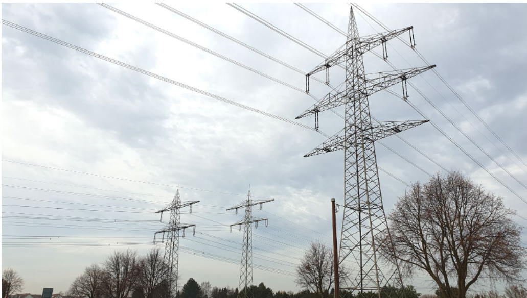
Abb. 10: 110 kV, 220 kV und 380 kV-Hochspannungsleitungen
