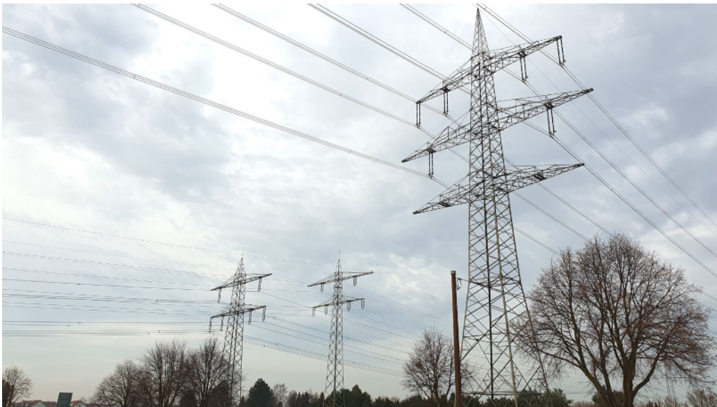
Abb. 10: 110 kV, 220 kV und 380 kV-Hochspannungsleitungen
